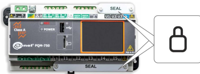
Rys. 6. Plombowanie wejść pomiarowych.
